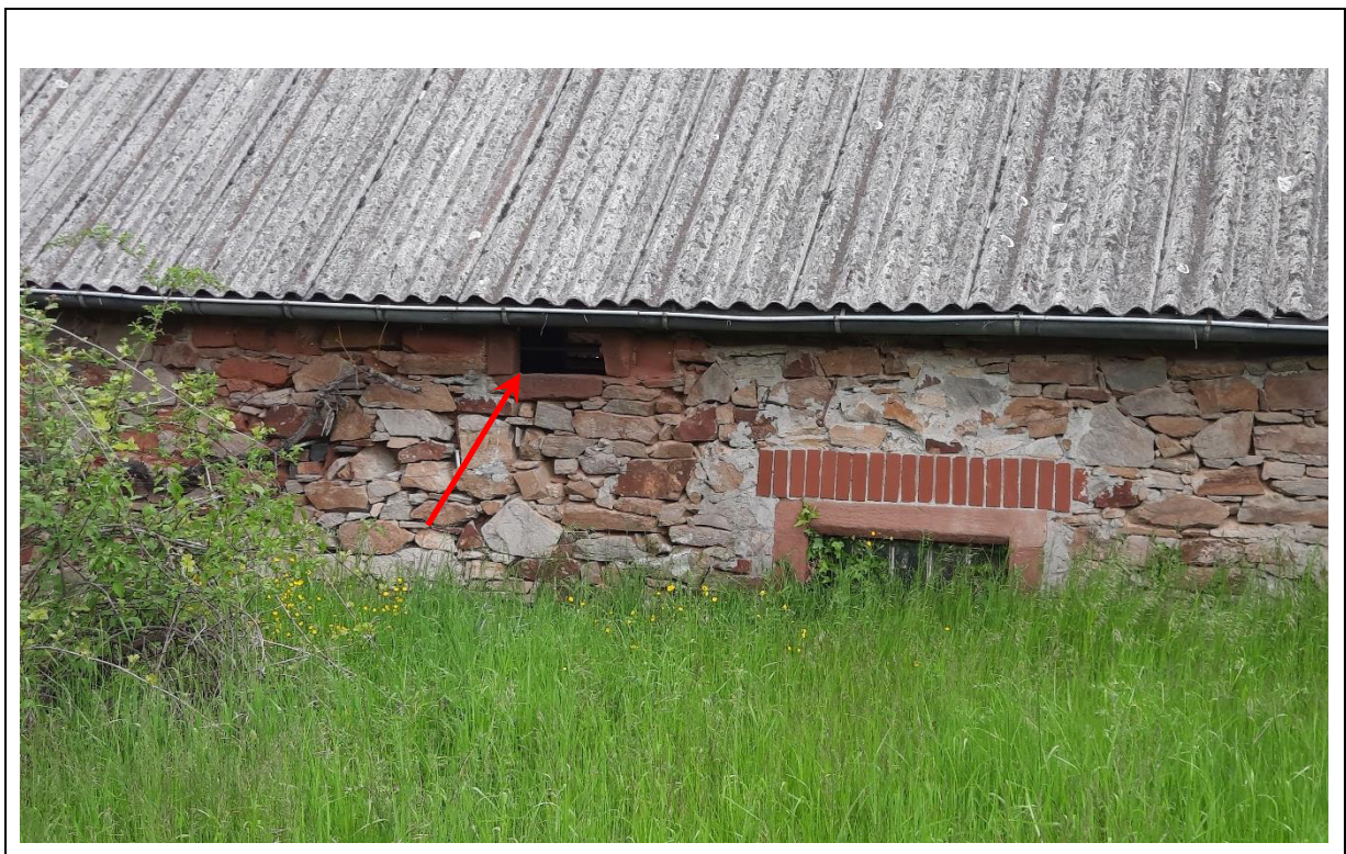
Abbildung 8: Öffnung in Mauerwerk, Mauerspalten
