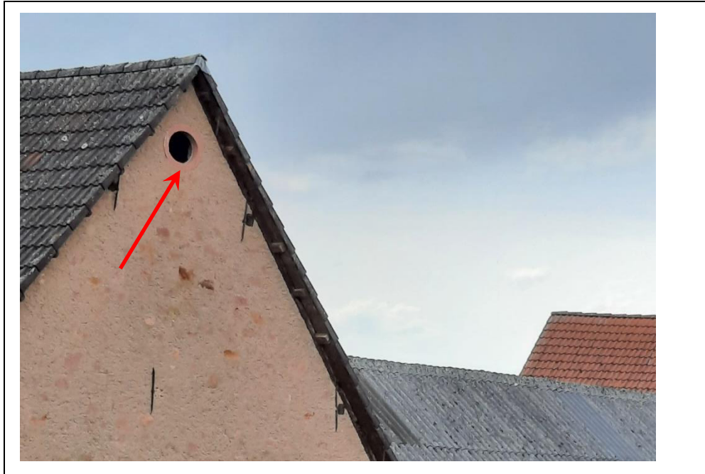
Abbildung 5: Lüftungsöffnung in einer Scheune
