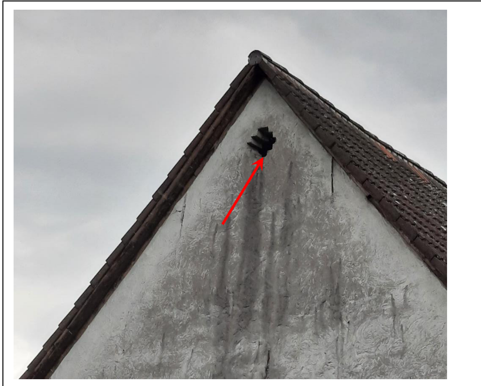
Abbildung 7: Lüftungsöffnung in einer Scheune
